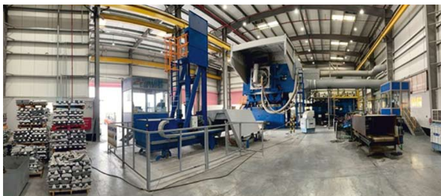
Schmelzanlage für Aluminium in Doha
