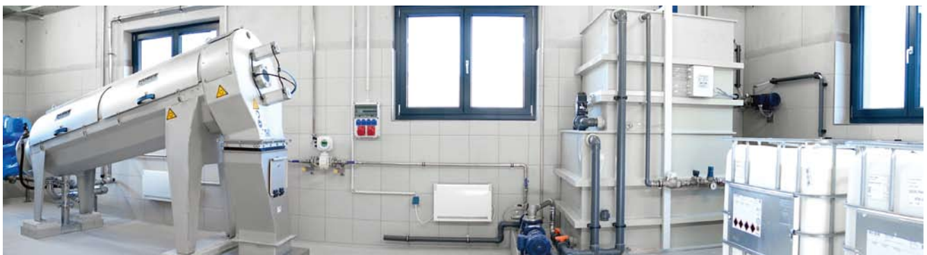
HUBER Schneckenpresse Q-PRESS® 440.2 auf der Kläranlage Parsberg
