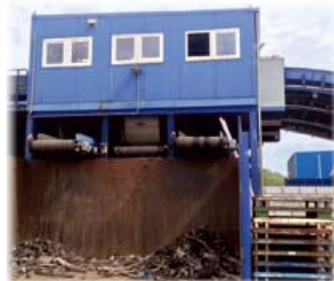
Be- & Entlüftung von Sortierkabinen
