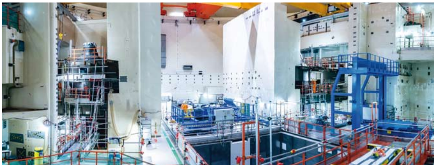
Blick in den Kontrollbereich des Kraftwerks
