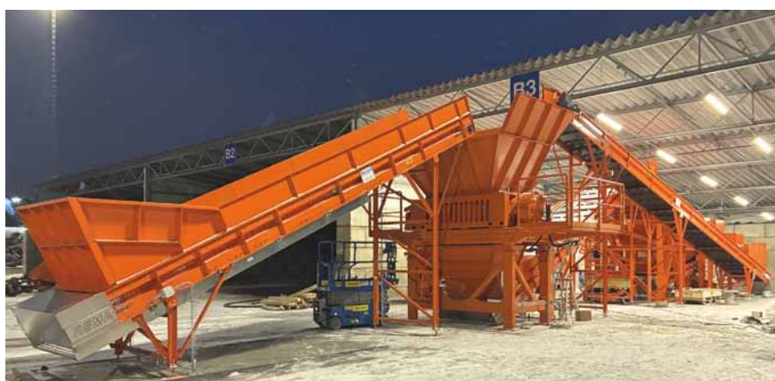
Die B2.000 Linie vor der Warm-Inbetriebnahme
