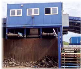
Be- & Entlüftung von Sortierkabinen
