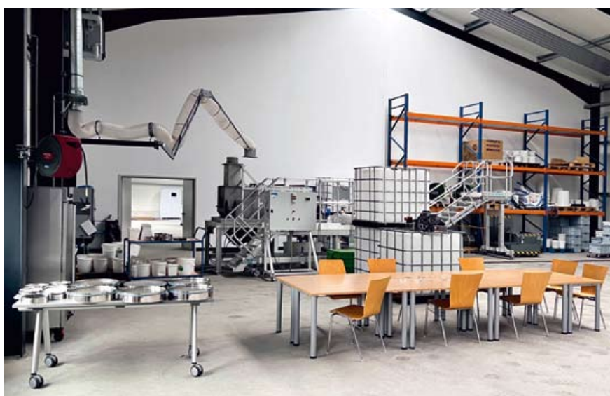
Die Halle beheimatet Pilotanlagen zur Aufbereitung und Sortierung von mineralischen Baureststoffen
