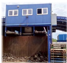
Be- & Entlüftung von Sortierkabinen
