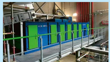
BatterySort-System eingebaut in der Sortieranlage von PreZero Austria
