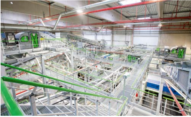
Stadler-Sortieranlage in Österreich
