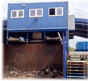
Be- & Entlüftung von Sortierkabinen
