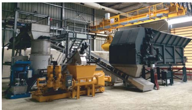
Annahmedosierer für Kranbeladung als Aufgabebunker
