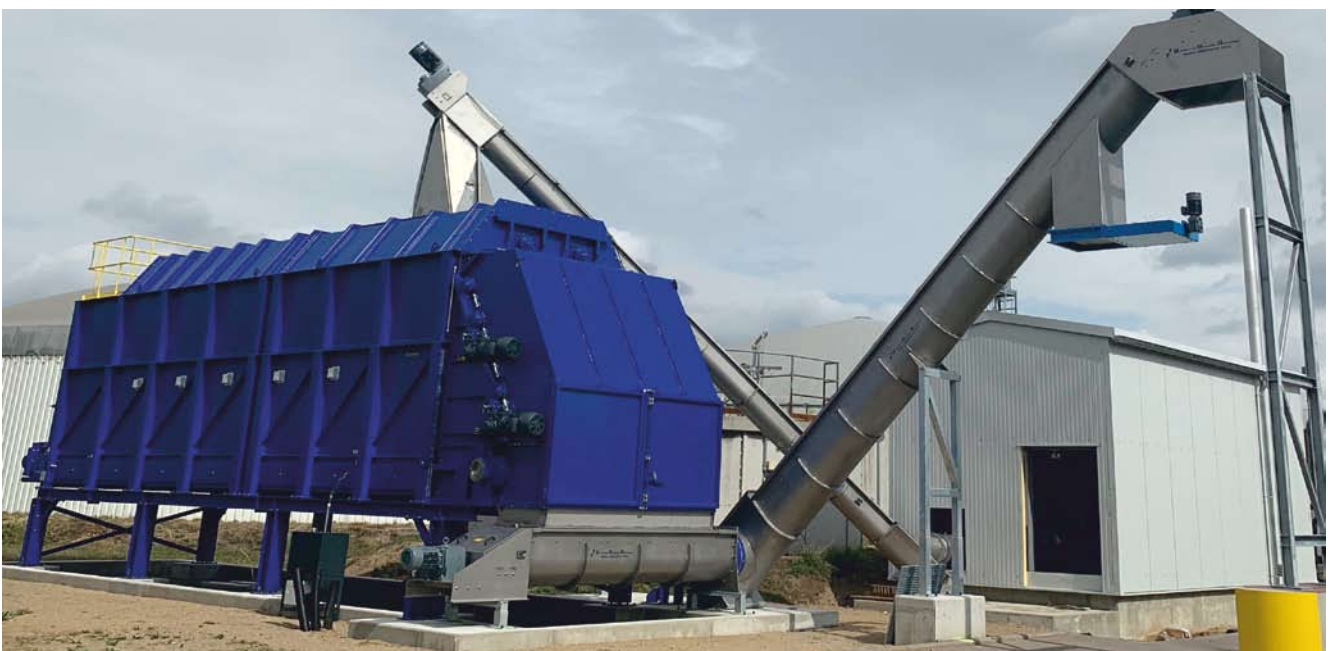
Annahmedosierer als Zwischenspeicher mit Abförderschnecken für die schnelle Lkw-Beladung
