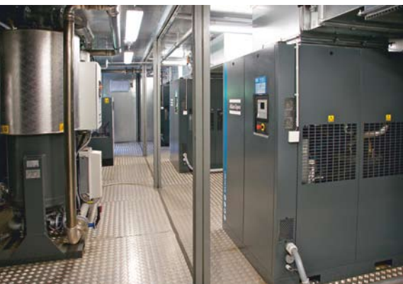
Die komplette Druckluftstation ist in zwei parallel miteinander verbundenen 40-Fuß-High-Cube-Containern untergebracht. Drinnen herrscht eine fast hermetische Atmosphäre, da die benötigte Außenluft über Filtermatten gereinigt wird
