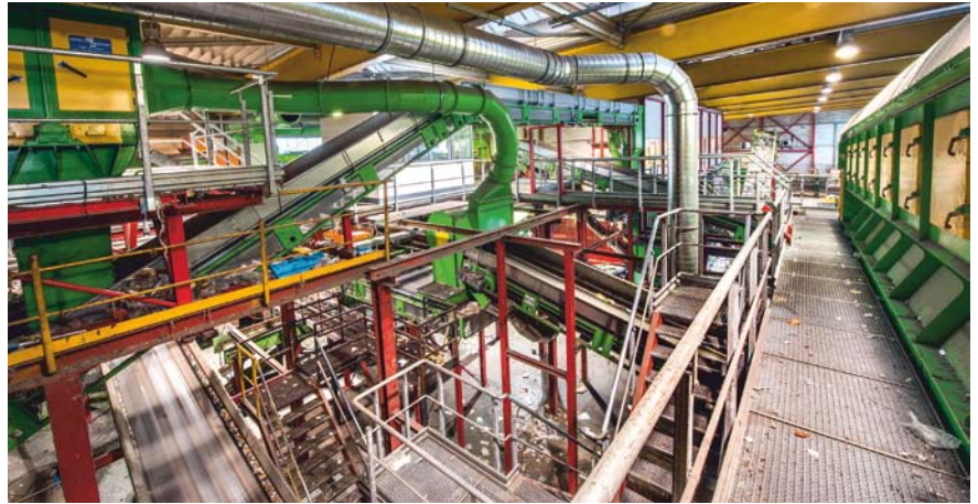
In Neukühschwitz bei Rehau betreibt die Böhme GmbH die zweitgrößte Wertstoffsortieranlage Bayerns
