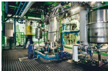
Vakuumdestillationsanlage am Standort Bitterfeld-Wolfen
