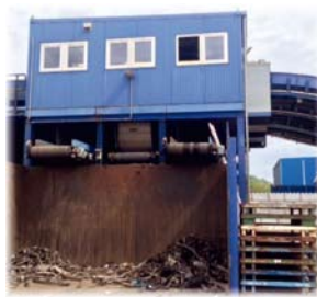
Be- & Entlüftung von Sortierkabinen
